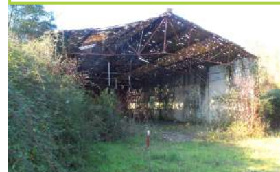
hangar délabré proche de La Dronne
